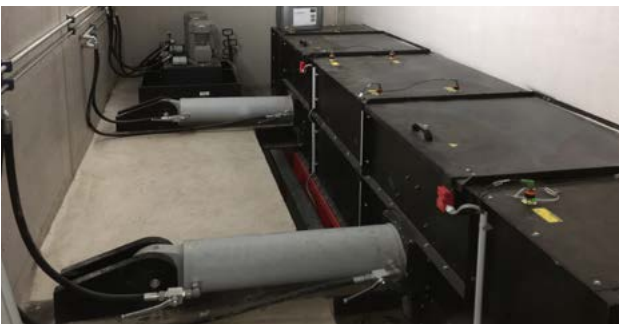
Massive hydrauliske cylindere sikrer bevægelse af gulvet
